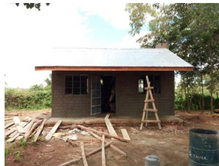
Vanuit Kenia kregen we foto's toegestuurd van deze laatste keuken die nu bijna af is.
