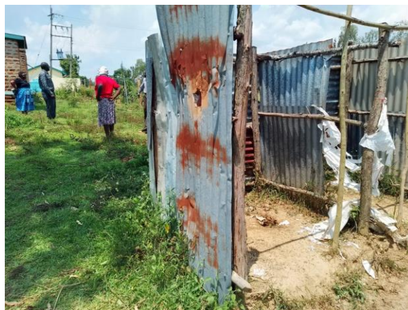
De jongens wc van de Ogeda Primary School zonder deur.
